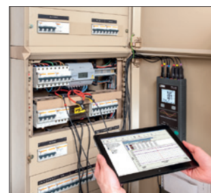
Obr. 2. Analyzátor PEL 103 přímo v rozváděči
