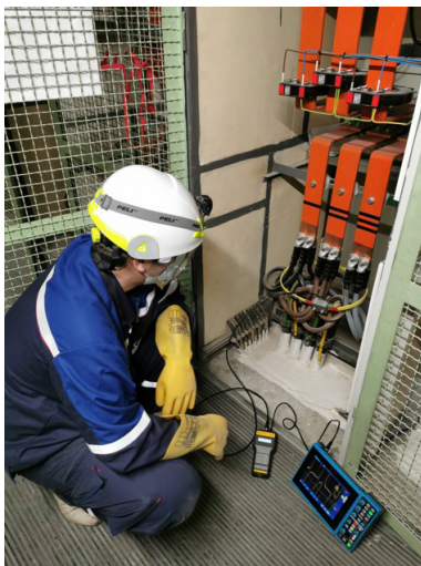
Obr. 5 Lokalizace poruchy izolace s přenosným systémem Bender EDS3090
